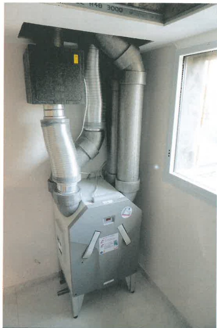
La ComfoAir 350 Zehnder est installée près de l'entrée de service avec une prise d'air extérieure. Le boîtier haut contient les filtres; le coffret bas, l'échangeur, le réchauffage et les ventilateurs. Les tuyaux cannelés diminuent le bruit généré par la circulation de l'air.
