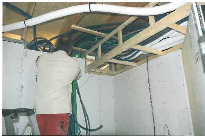
Le circuit de ventilation et les réseaux sont logés dans le plafond pour desservir tout à la fois le rez-de-chaussée que l'étage. Au départ de l'échangeur dans le cellier, le menuisier a réalisé un coffrage de plafond pour faire passer tous les réseaux et les camoufler.
